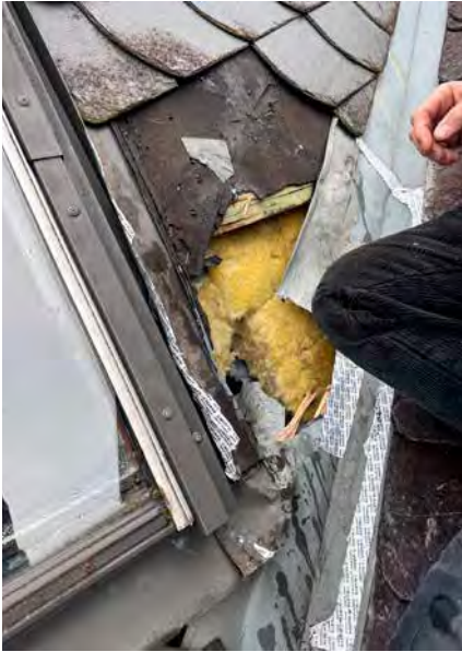
Die Fragmente des Meteoriten hatten die Schiefereindeckung auf dem Dach in Koblenz-Güls durchschlagen und dann das Holzgebälk, die Dämmung und innen die Holzvertäfelung als Wandverkleidung sowie Fliesen zerstört. Auch das angrenzende Fenster wurde am Rahmen beschädigt.
